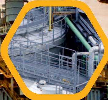
Cooling Towers Soğutma Kuleleri
